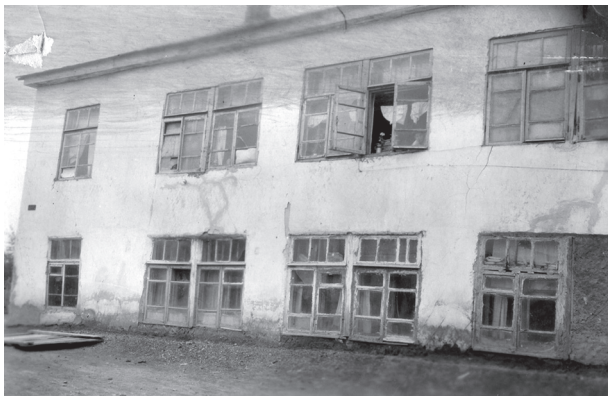
Разрушающийся жилой дом № 9 по Железнодорожной улице. Послевоенный период.
